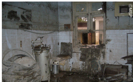
2mの高さまで泥水に浸かったノウシャラ病院の内部。
